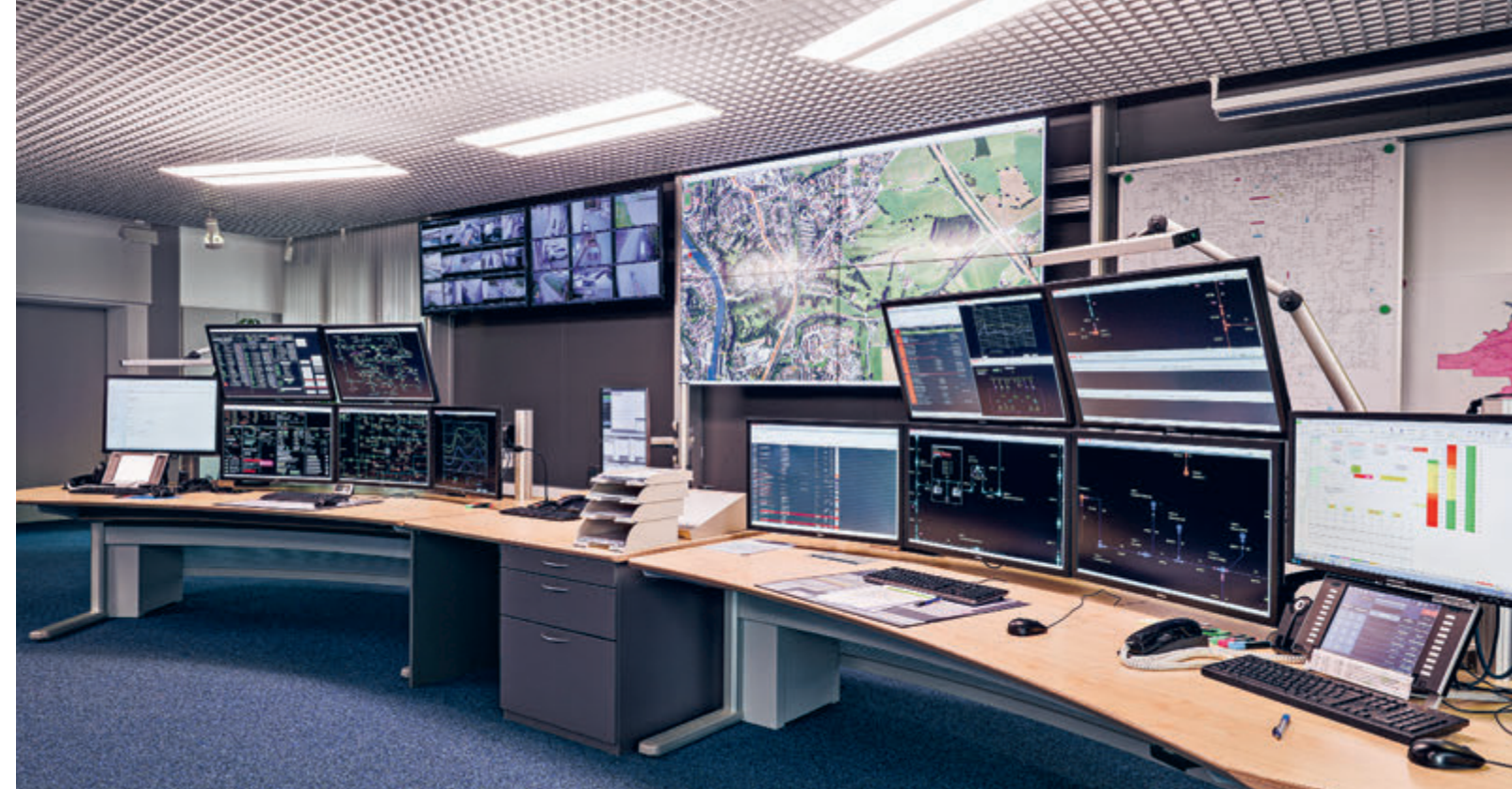
Alles im Blick In der Netzleitzentrale von AllgäuNetz werden Netzereignisse sofort registriert
